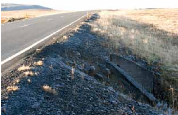
Skarð í veg og hættulegt steypt ræsi
