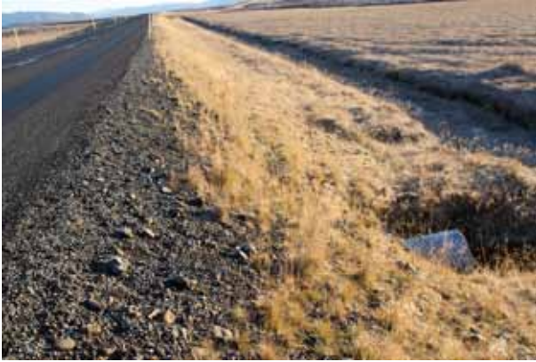
Ræsi við vegbrún, mjög erfitt að finna, en samt hættulegt
